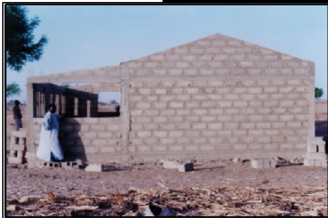
Sur le chantier de la nouvelle case communautaire de Pinakop, en mai dernier (photo PCR fissel)
